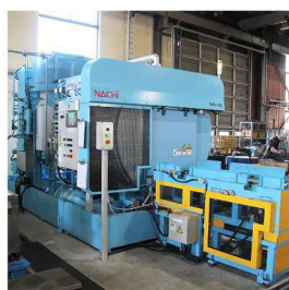
田尻工場 田尻設備
