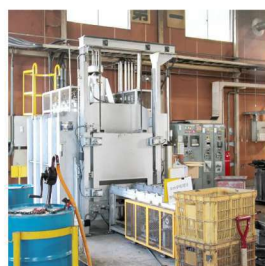
田尻工場 田尻設備
