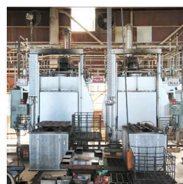
田尻工場 田尻設備
