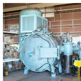
田尻工場 真空熱処理炉
