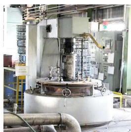
本社 ピット型浸炭炉
